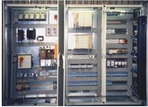
Schaltschrank zur modernisierten Schleifmaschine, gegliedert in Leitungs- und Steuerungsteilen für die CNC- und SPS-Steuerung
